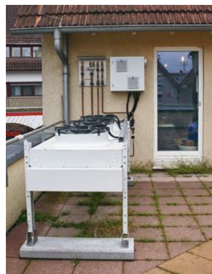
Muss draußen bleiben: Gaskühler mit 40KW Leistung.
