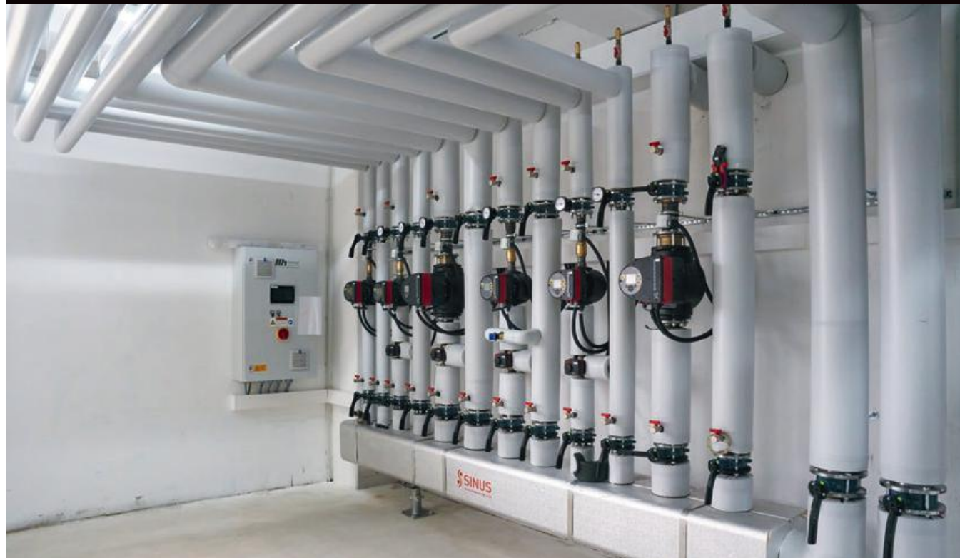
Verteilstation für Prozessmedien, ausgeführt nach neuestem Effizienzstandard.
