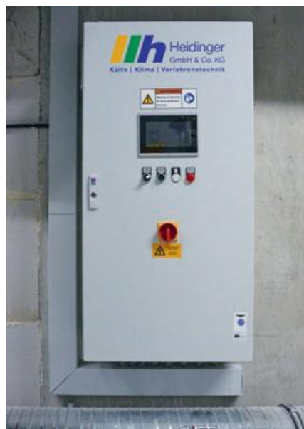
Durchdachte Technik von Heidinger: Fernüberwachte Zentralsteuerung der OP Lüftung.
