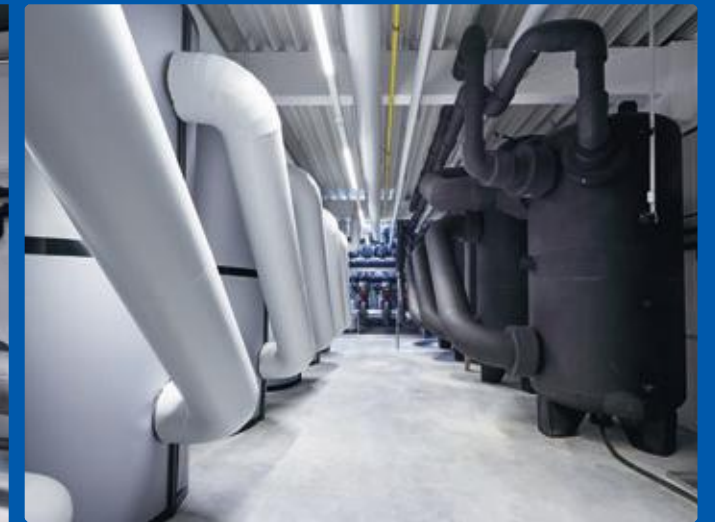
Puffertanks: Je 10.000 Liter Warm- und Kaltwasser
