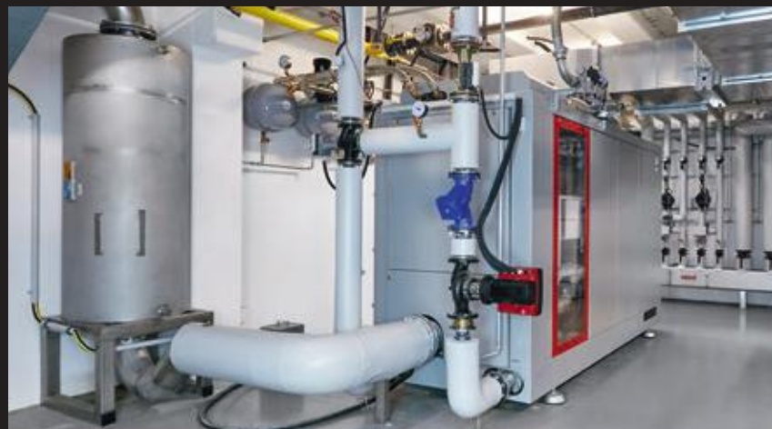
Preiswerte Prozesskälte und Energie satt: Leistungsstarkes BHKW bei Böhmler Drehteile in Pforzheim.
